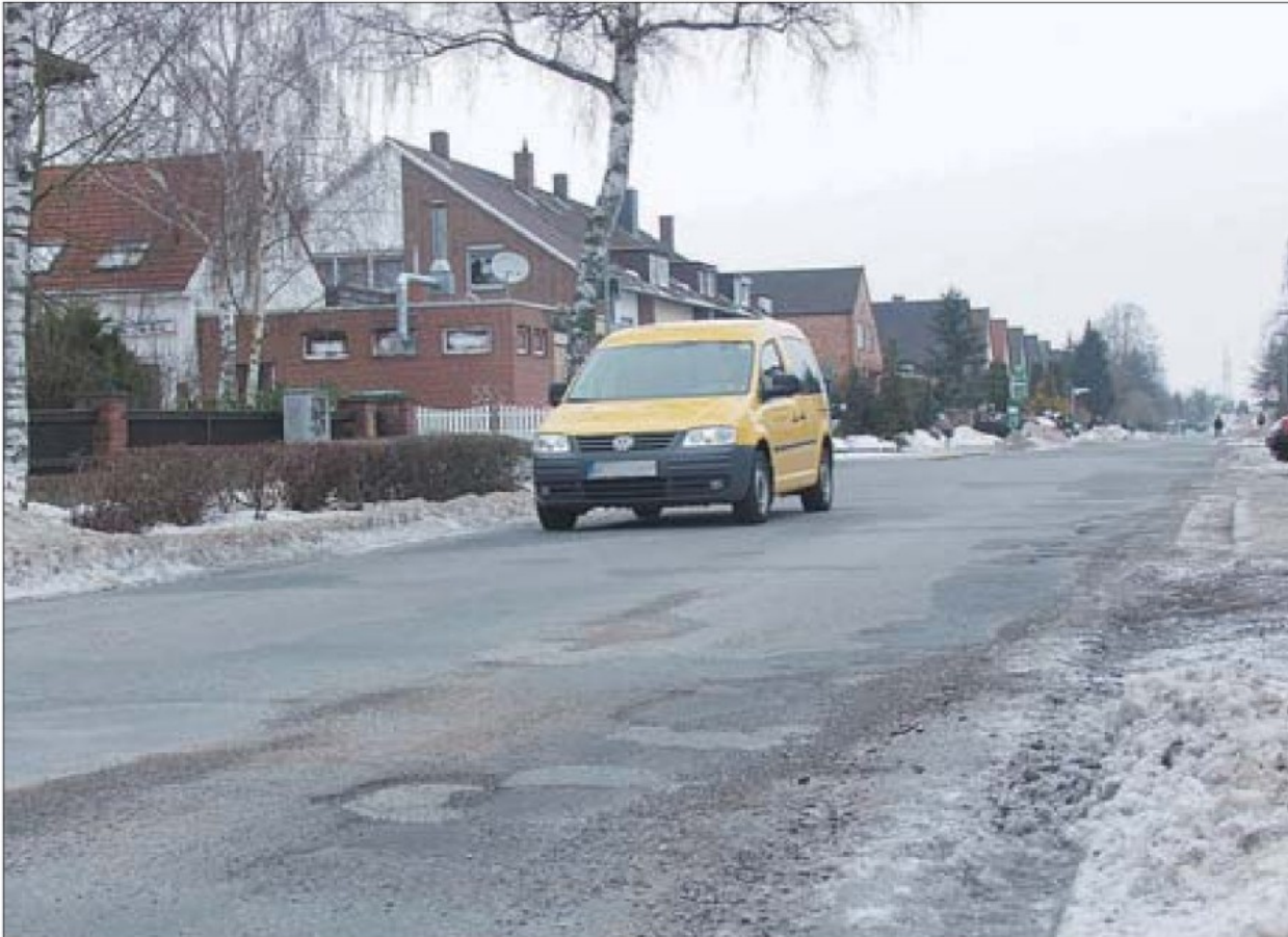
Schlaglöcher, Risse und Dellen: Die mehr als ein Kilometer lange Straße Zum Großen Freien in Ahlten ist an zahlreichen Stellen beschädigt. Eggers
