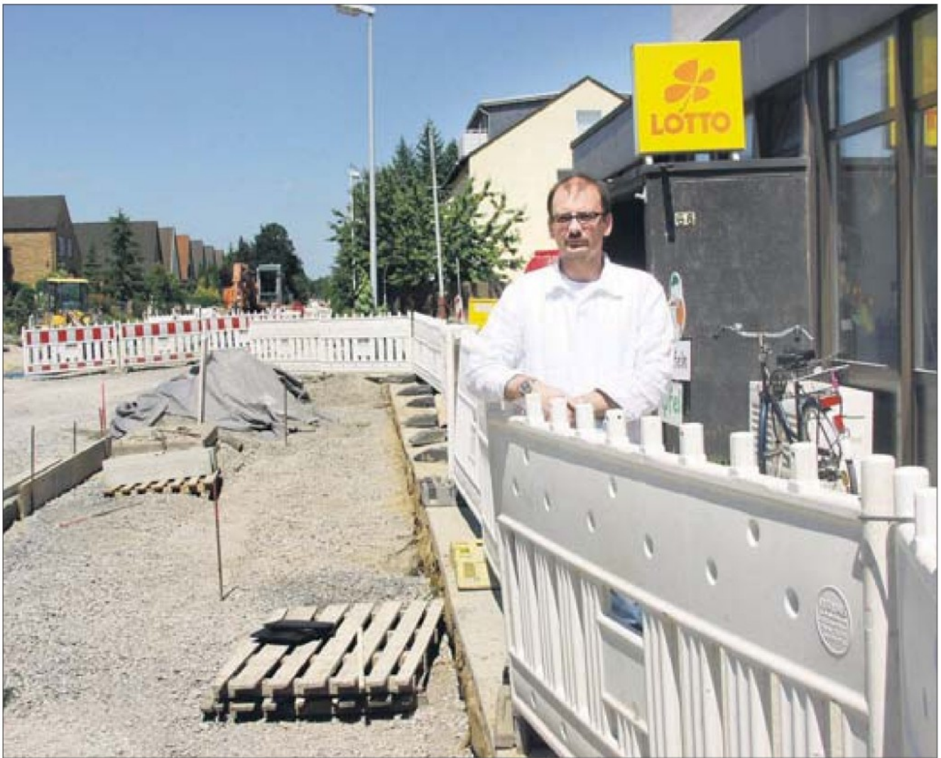
Michael Franz hat weniger Kunden: Weil die Bauarbeiten an der Straße Zum Großen Freien auf Hochtouren laufen, ist sein Kiosk nur noch eingeschränkt erreichbar. Eggers (2)
